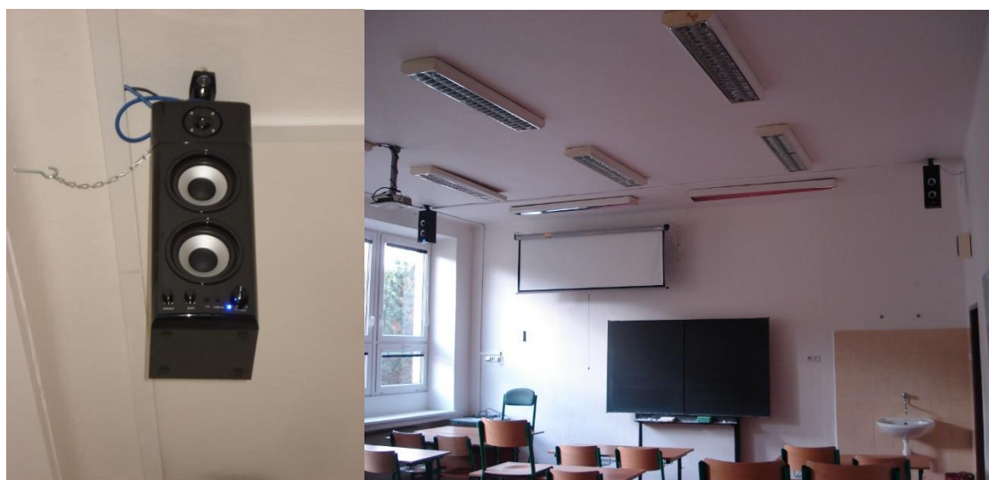
Instalace ozvučení kmenových i odborných učeben červen – srpen 2019
